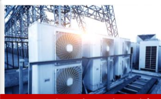
HVAC( climatización y ventilación)
